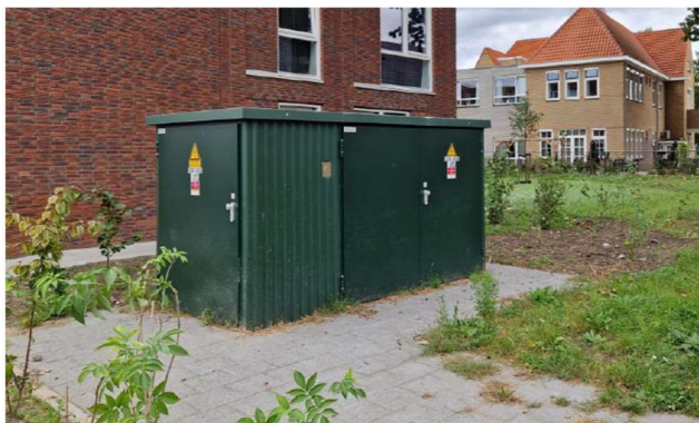
Figuur 12: voorbeeld elektriciteitsstation zonder beschildering of bestickering. Bron: Enexis
