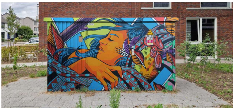
Figuur 13: voorbeeld van elektriciteitsstation met beschildering of bestickering. Bron: Enexis
