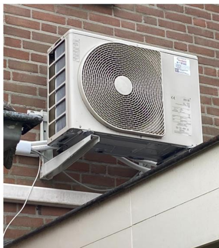
Buitenunit hybride warmtepomp aan de gevel
