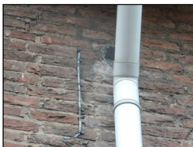
Figuur 19. Gat in muur bij basisschool die geschikte verblijfplaats voor vleermuis vormt.
