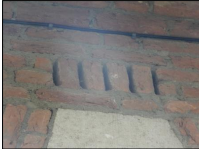
Figuur 13. Stoetvoegen bij basisschool die geschikte toegang verlenen voor vleermuizen.
