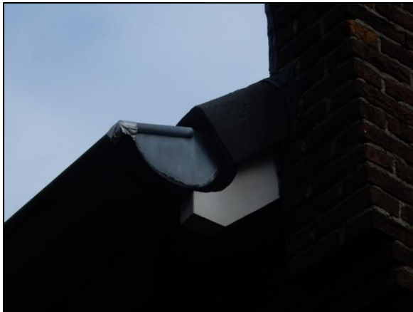
Figuur 11. Dakgoot met toegang tot ruimte onder dakpannen geschikt voor huismus bij basisschool.
