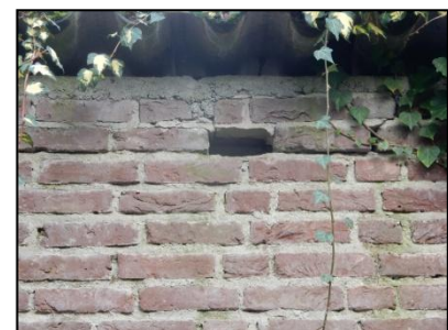
Figuur 21. Gat in muur rond speelplein basisschool die geschikte verblijfplaats voor vleermuis vormt.
