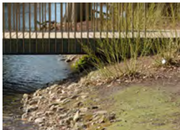
Geen constructieve elementen in water of oever
